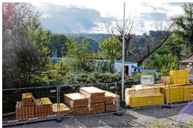
Wie auf der Albbrucker Seite unmittelbar vor dem Fahrradhotel sind auch auf der Schweizer Seite die Sanierungsarbeiten des Rheinstegs in vollem Gange.
